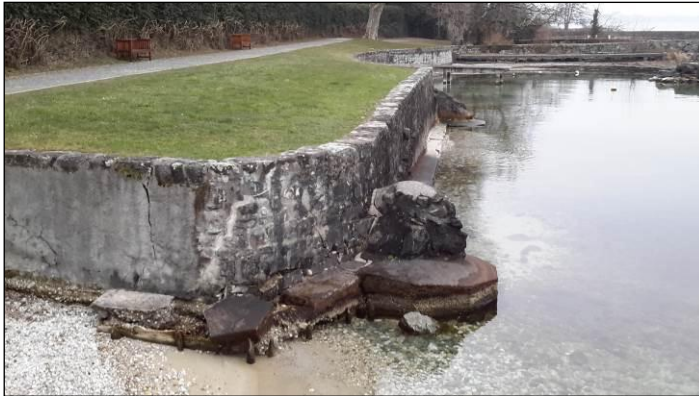
Mur abîmé : fissures importantes et décrochements de la semelle
