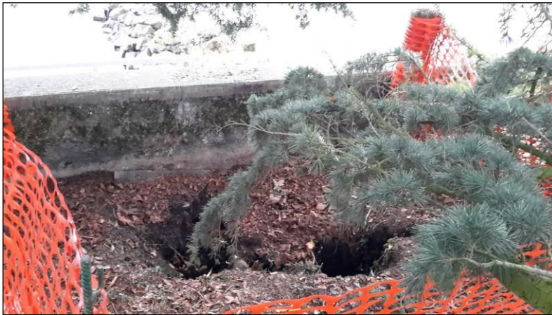
Trou survenu par l'affouillement lié à la dégradation du mur (hiver 2014/2015)
