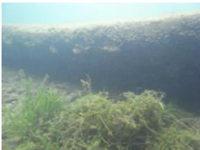
Affouillement sous la rampe de mise à eau
