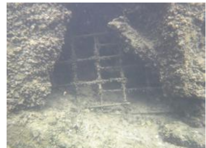
Cavité avec armature visible sur la base du mur
